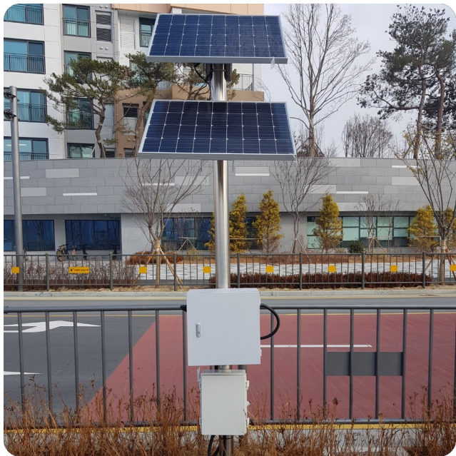
현장 설치 디바이스 — 태양광 패널 · 센서 · 제어부
